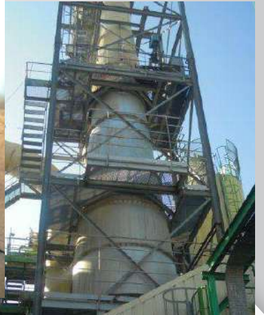
Duman soğutma kulesi
