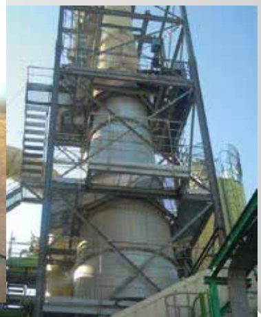
Torre de enfriamiento de humos
